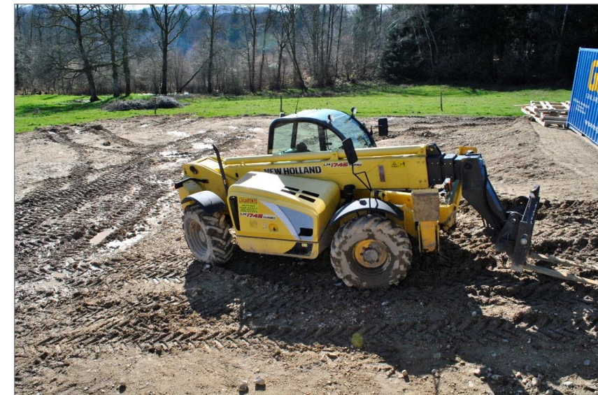
Photographie 41 : Exemple de tassement et d'ornières créés par les engins de chantier
